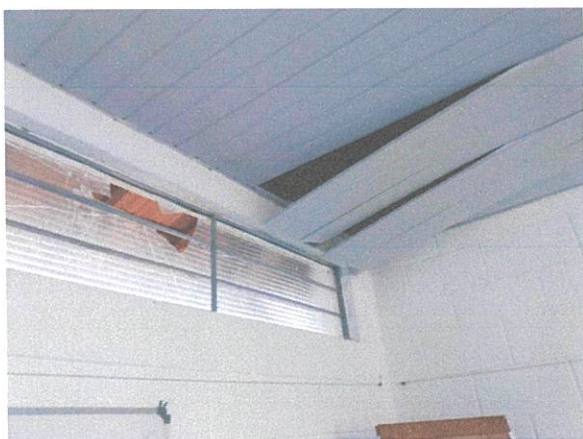
Forro caindo e vidro quebrado
