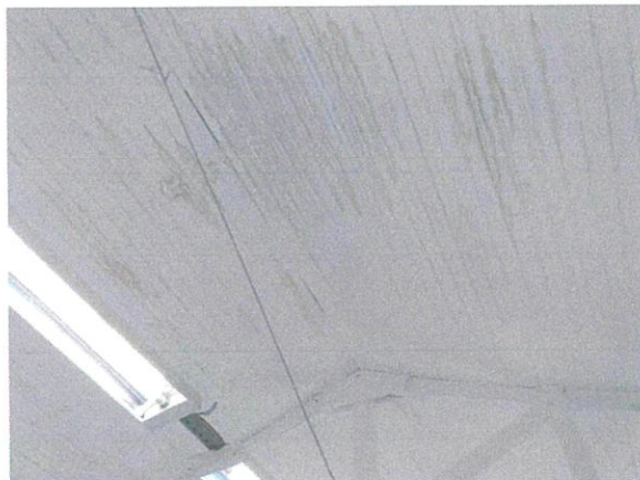
Forro com aparência de bolor
